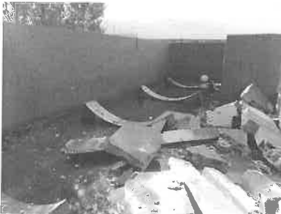
Mise en évidence d'eau de ruissellement dans la fosse du réservoir (R1)
