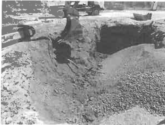
Remblaiement de la fouille au droit des pistes de distribution avec des matériaux propres
